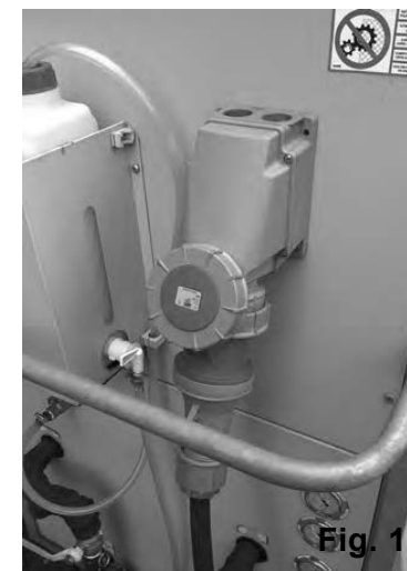
Fig. 1 - Connecteur d'entrée 400 volts, 125 ampères, 5 pôles, qui se trouve sur le groupe froid de 100 kW
